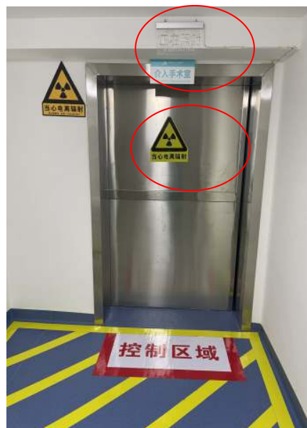
图 4-5 本项目 3 号手术室防护门当心电离辐射警示标志及工作状态指示灯
