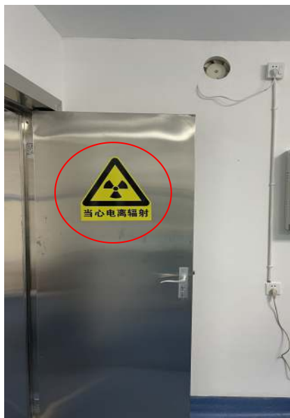
图 4-4 本项目控制室防护门当心电离辐射警示标志
