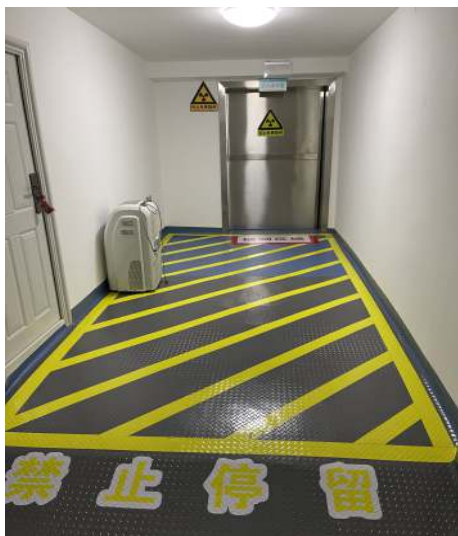
图 3-5 3 号手术室东侧控制室及通道
