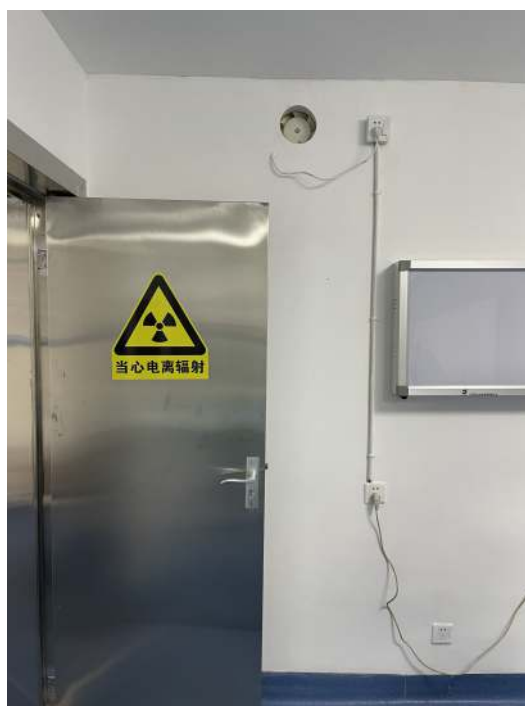
图 4-10 机房内通风装置
